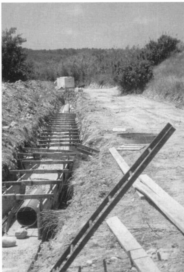
Col·lector d'aigües residuals construït l'any 1997 pel mig del llit del riu
