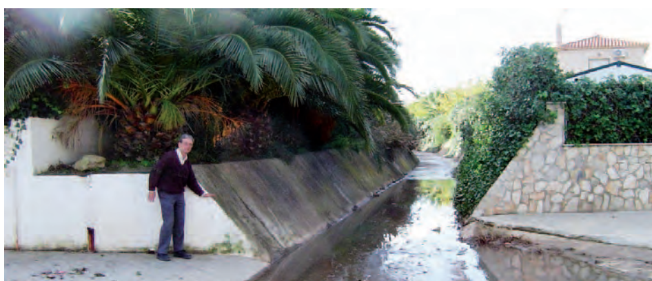
L'embocament del canal de La Rasa, de secció trapezoïdal, després de l'avinguda dels dies 26 i 27 de novembre de 2003, indicant la cota assolida de l'aigua d'escolament.
