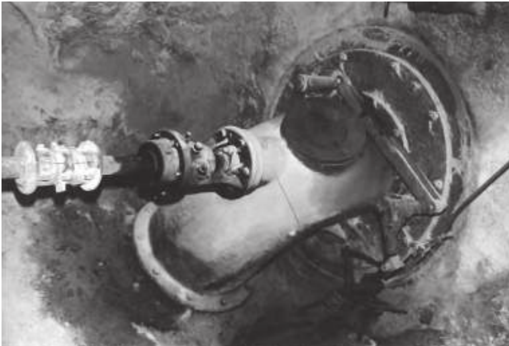
Turbina hidràulica Francis
