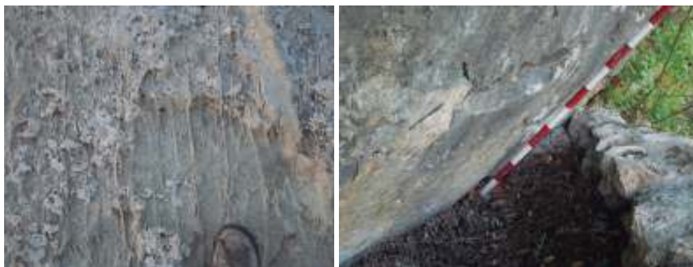
Figures 3 i 4: Estructures indicadores de la neotectònica en el litoral d'Altafulla. Esquerra: Estructures verticals en els extensos afloraments damunt el Fortí. Dreta: Miralls de falla 12 al turó del Castell, en els afloraments vora la bassa del Castell
